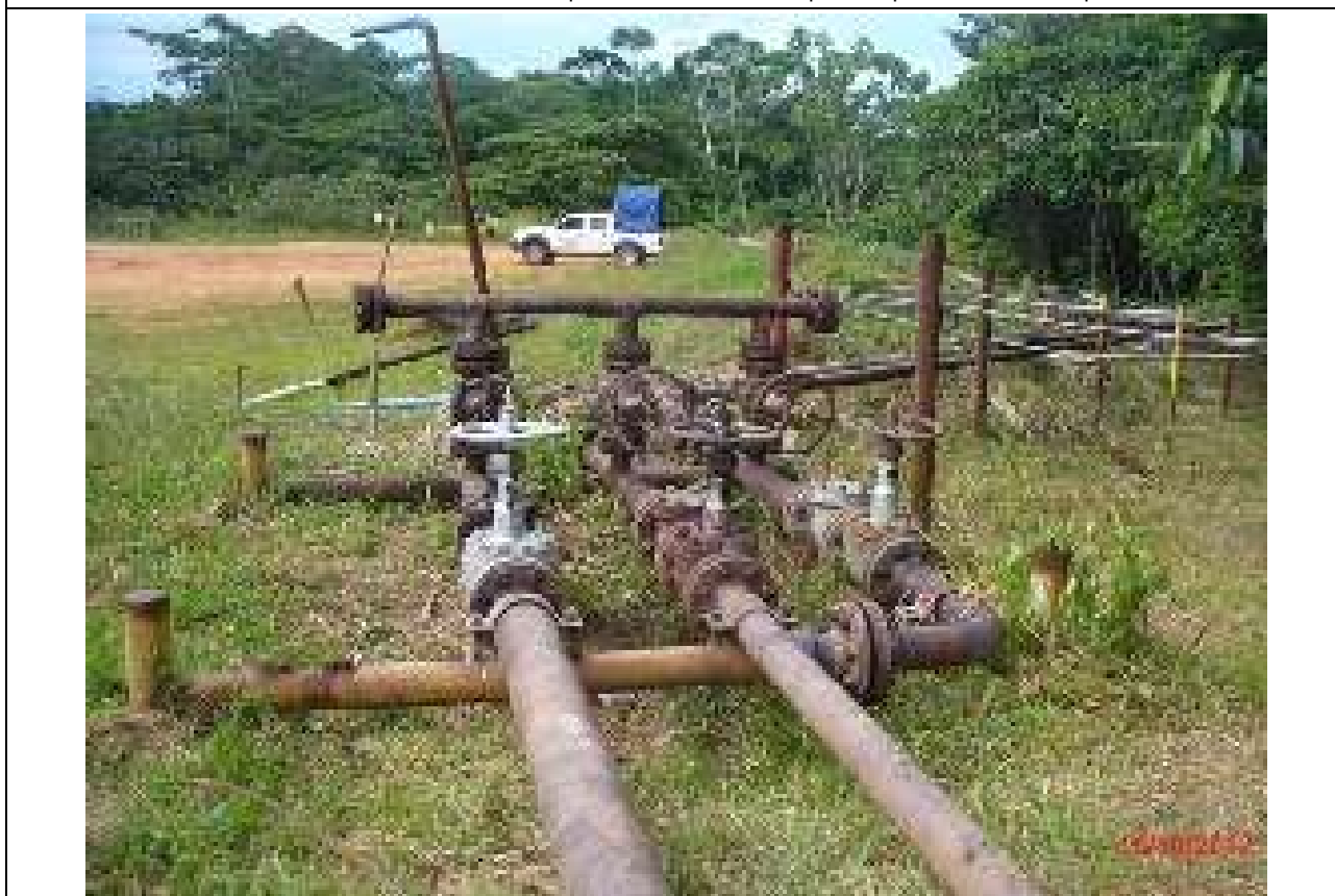
FOTO 20. Manifold a donde están conectadas las líneas de flujo de los pozos, al manifold le falta numeración de los pozos, sin protección contra la corrosión.
