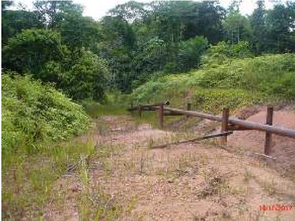
FOTO 9. Vista del tramo cambiado, el cual ha sido arrastrado hacia el interior de la selva, también en los alrededores han quedado otros tubos que fueron retirados.
