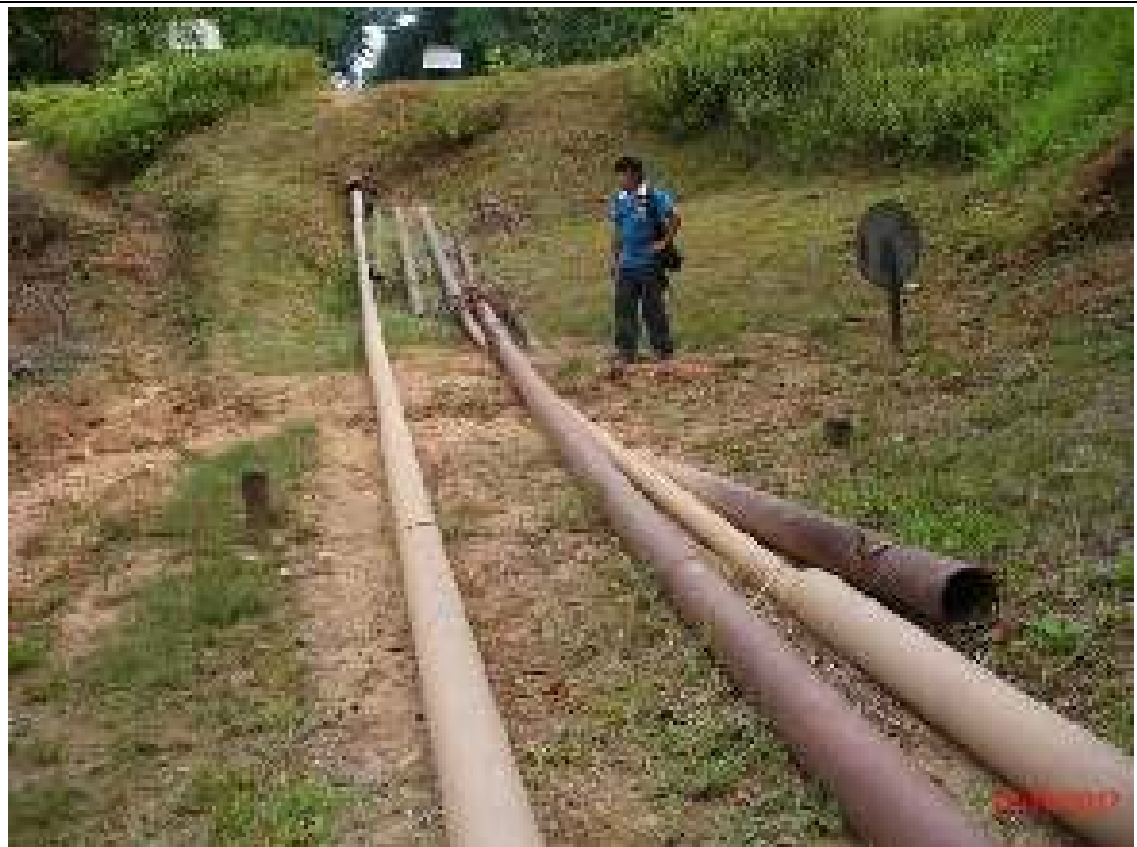
FOTO 24. Vista de las líneas de flujo de los pozos y otras tuberías que han sido abandonadas luego de los cambios efectuados a los tramos en mal estado.
