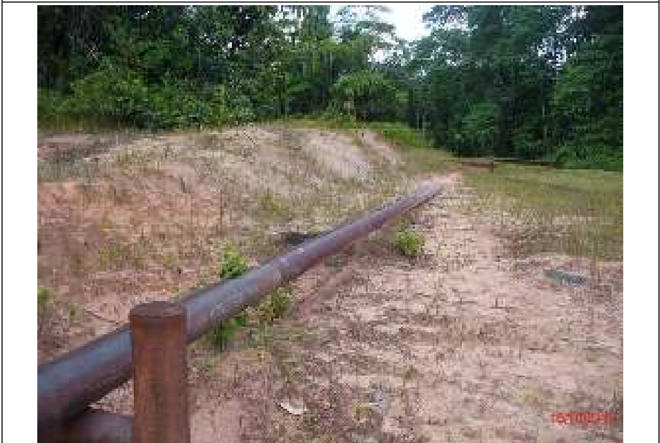
FOTO 8. Vista del otro extremo de la tubería cambiada sin protección de pintura contra la corrosión.
