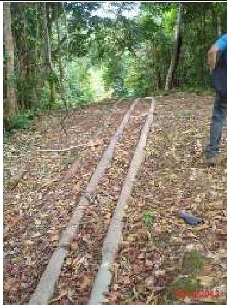
FOTO 22. Otra vista de la tubería tendida sobre el suelo sin ninguna protección contra la integridad de la tubería.
