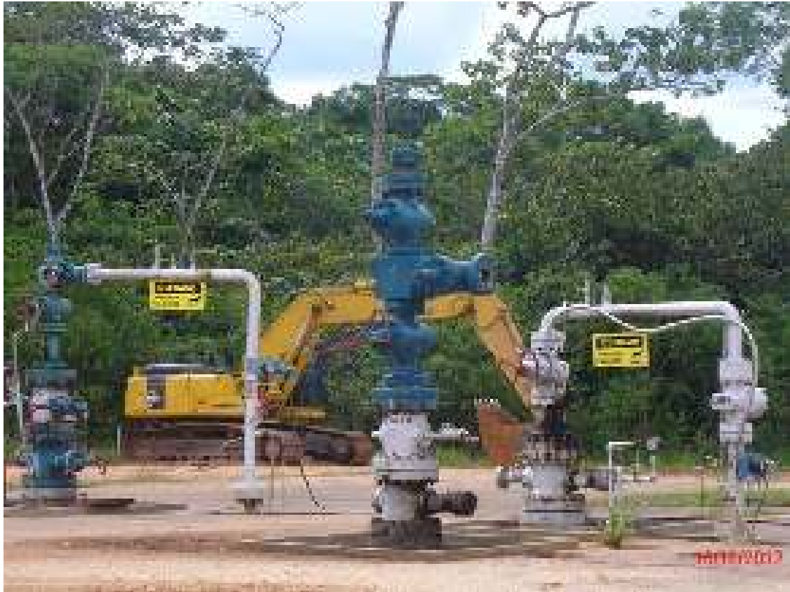
FOTO 13. Vista del Pozo CS18 estado productor, Pozo CS19 estado ATA y Pozo CS20 inyector de agua de producción. Cabezal del pozo productor manchado con petróleo por fuga en el minimandrell.
