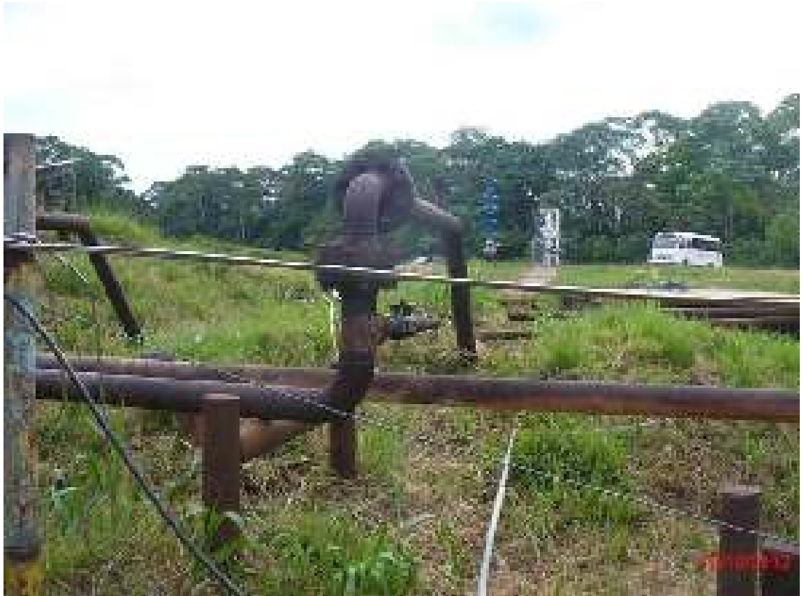
FOTO 18. Tuberías, línea de flujo que sale del Pozo CS18 y de reinyección, que entra al pozo reinyector.
