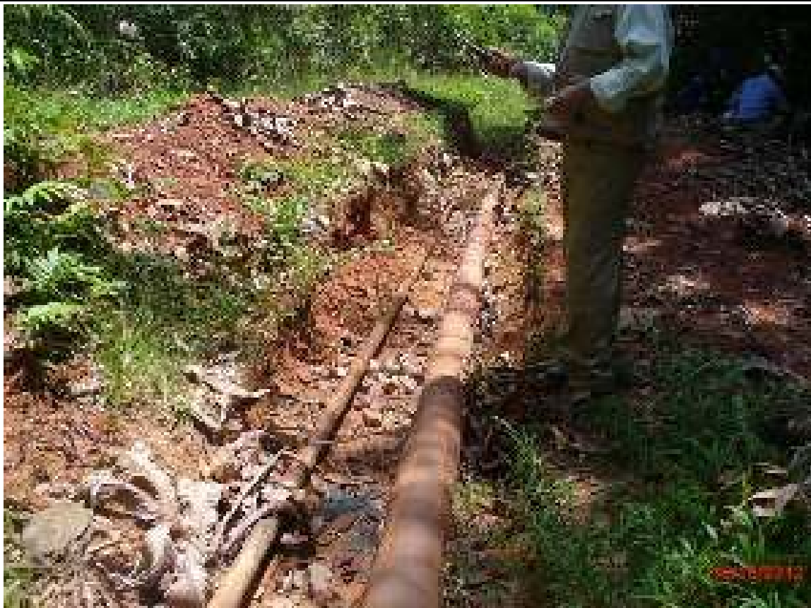
FOTO 6. Vista de la línea de flujo del Pozo CN08 que se evidencia signos de estar en mal estado
