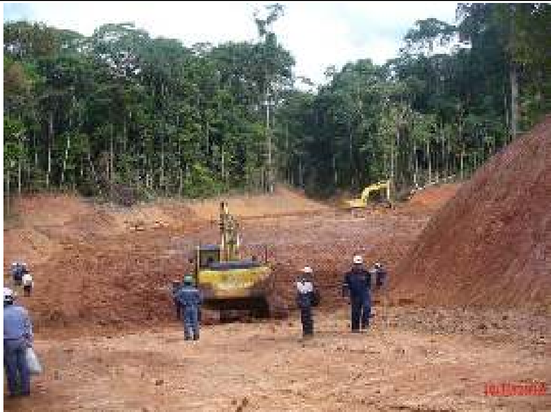
FOTO 14. Bajada hacia la Quebrada Shanshococho, se observa maquinarias de la empresa CORPESA revolviendo el terreno del área.
