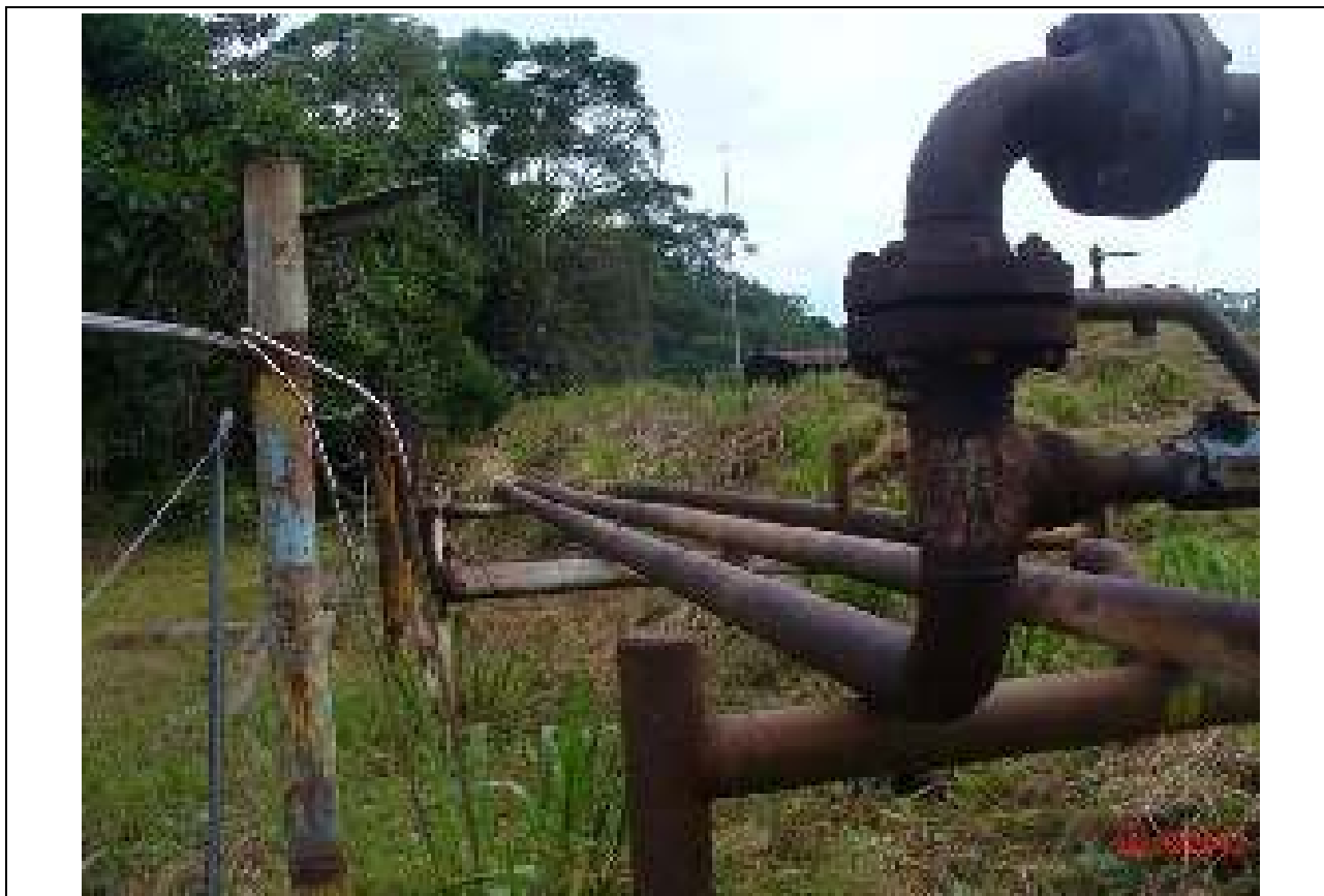
FOTO 19. Tramo al costado del terraplén donde se observa que esta parte está sobre soportes.
