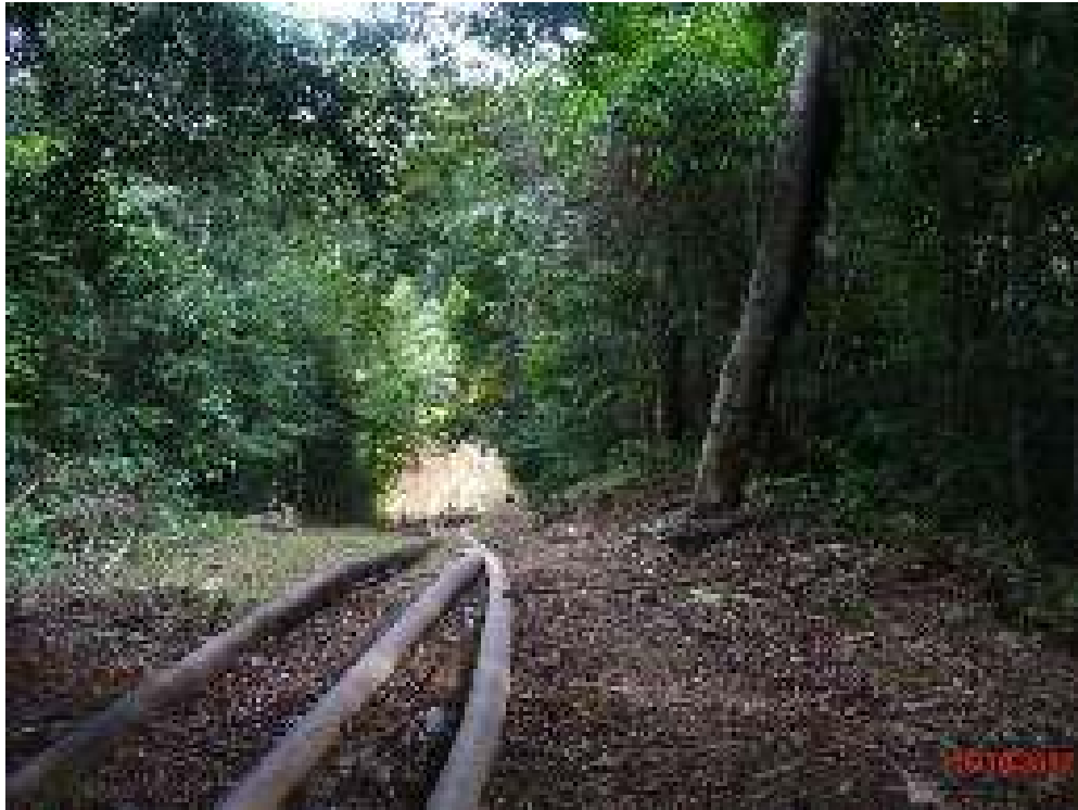
FOTO 21. Líneas de flujo de los pozos que se encuentran tendidas sobre la superficie del terreno y sin ninguna protección contra la corrosión.
