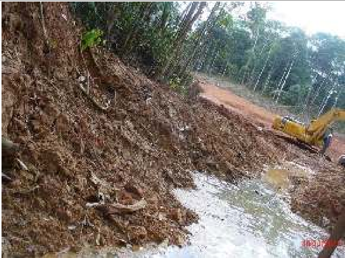
FOTO 16. Vista de otra quebradilla que alimenta la quebrada Shanshococho y donde se observa la presencia de una capa oleosa sobre su superficie.
