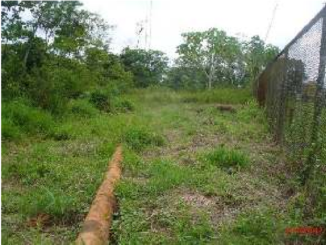
FOTO 35. Vista de una tubería aparentemente abandonada, tendida desde las instalaciones de PLUSPETROL hacia el muelle instalado en las orillas del río Pastaza.
