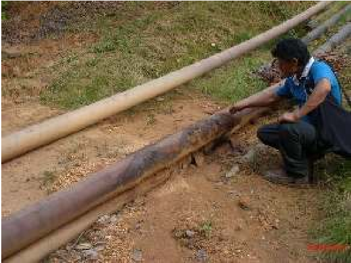
FOTO 25. Monitor de la FEDIQUEP ingresando un pequeño trozo de madera en un tramo en mal estado, cambiado y abandonado en el sitio, debajo de esta tubería una línea que se encuentra operativa
