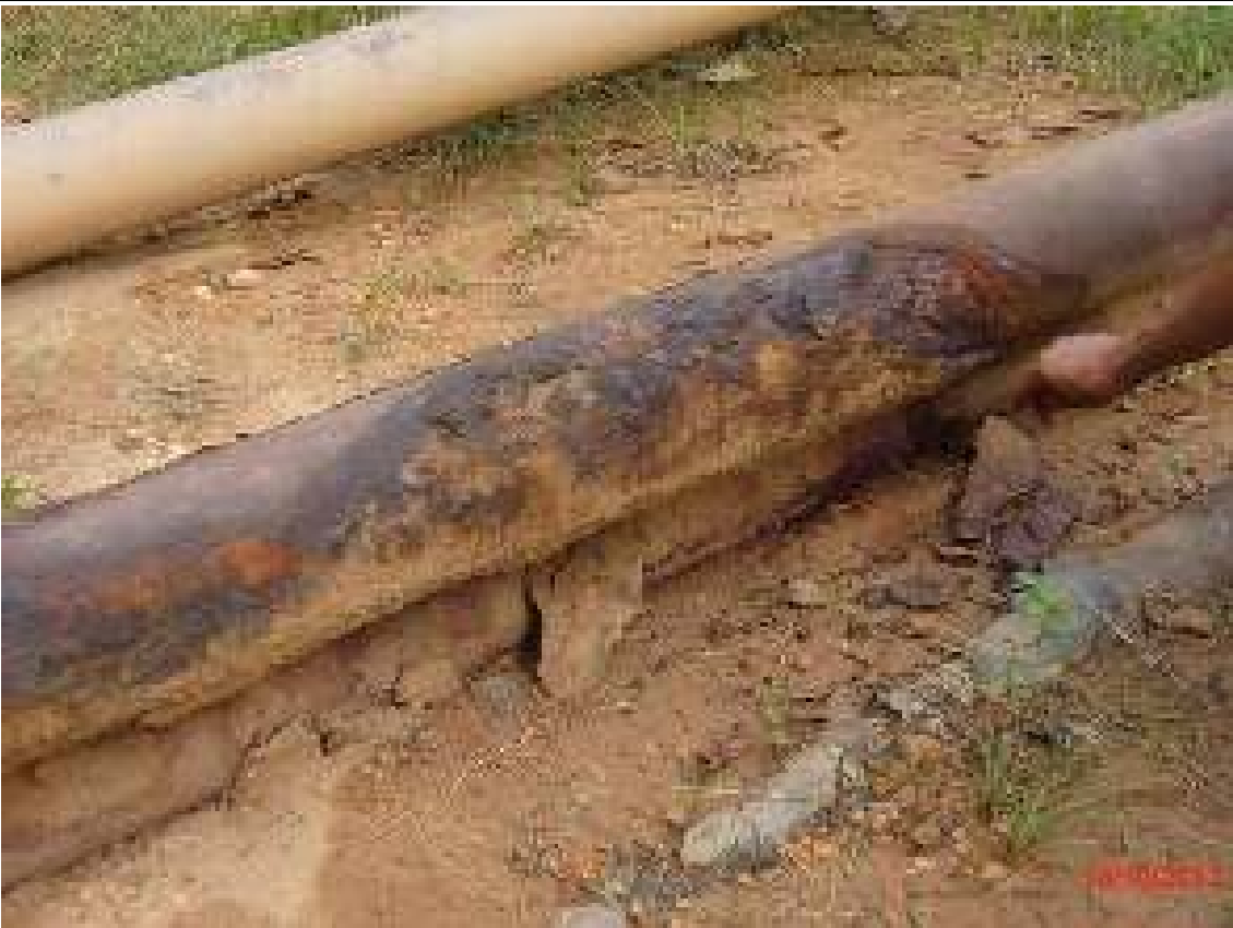
FOTO 26. Vista más cercana de la tubería en mal estado y se observa que la tubería operativa también tiene signos de encontrarse en mal estado.
