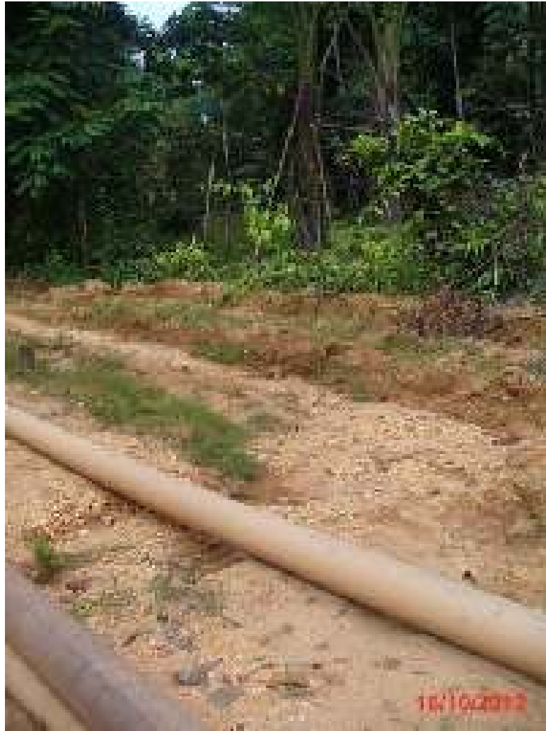
FOTO 27. Con esta vista se puede observar la cercanía de las tuberías en mal estado junto al inicio de la quebrada Shanshocochoa
